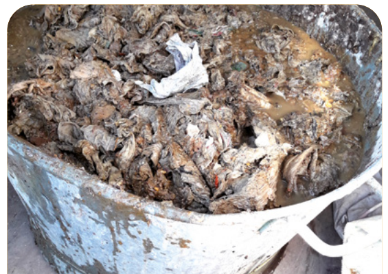
Le contenu d'un panier de poste de relèvement à Ambleny pour une semaine, et parmi ces lingettes, certaines dites « biodégradables ».
